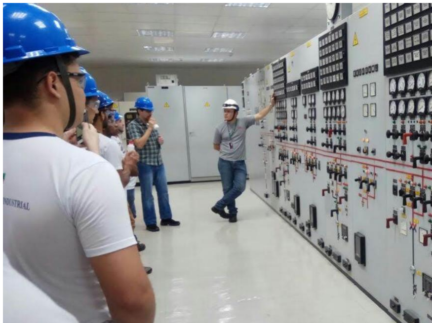
Painel de controle – Usina Hidrelétrica Mascarenhas - 2017
