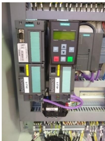
Figura 62 – Inversores de frequência Siemens
